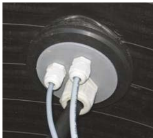
Pumppaamoon tuleva tiivisterengas ja vedonpoistajat
